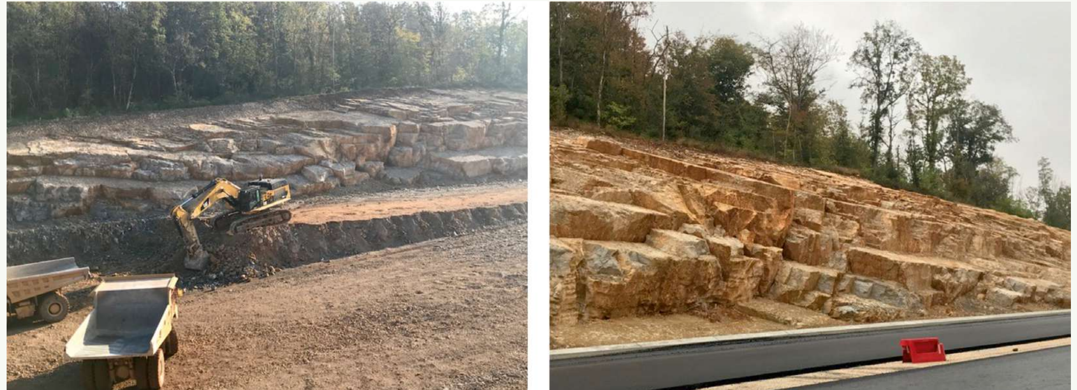
➤ Figura VIII. Ejemplo de RG siguiendo el método del Talud Royal. Izquierda, final de la fase operativa. Derecha, acabado final. Carretera RN 19, Departamento de Alto Saona (Haute-Saône) Francia. La estructura del nuevo talud rocoso se articula a partir de sus discontinuidades. Autor: P. Royal.
