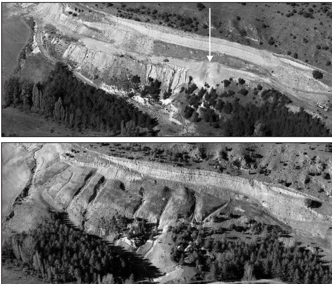
Figura 1. (Superior) inicio del proceso de restauración (octubre de 2008); la flecha indica el inicio de construcción de una de las vaguadas. (Inferior) situación posterior a la restauración (diciembre de 2008). Fotos Paisajes Españoles SA
